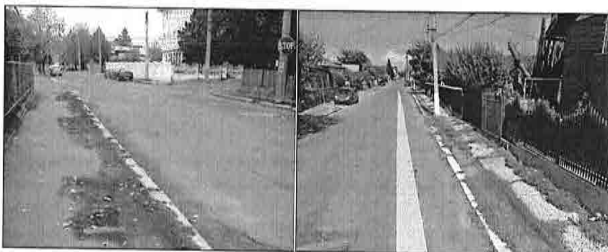
Figura 2.42. Trotuare în stare necorespunzătoare (Sursa: Google Earth, Arhiva Consultant, 2016).
