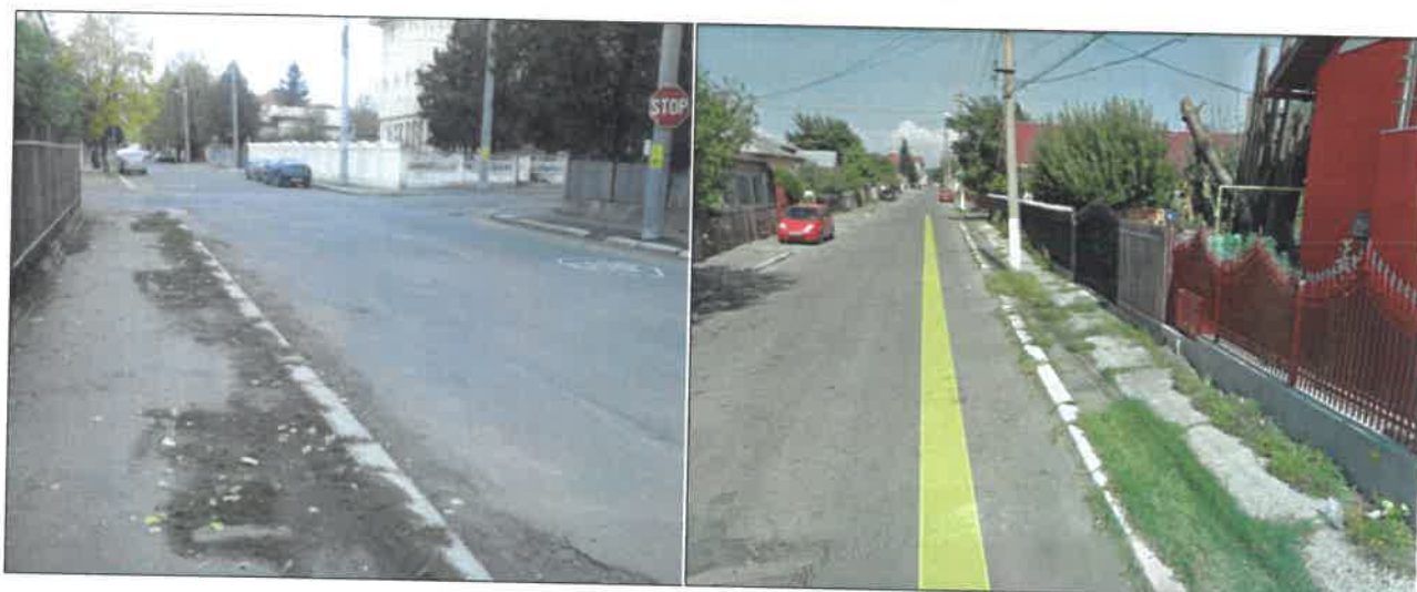
Figura 2.34. Trotuare în stare necorespunzătoare (Sursa: Google Earth, Arhiva Consultant, 2016).
