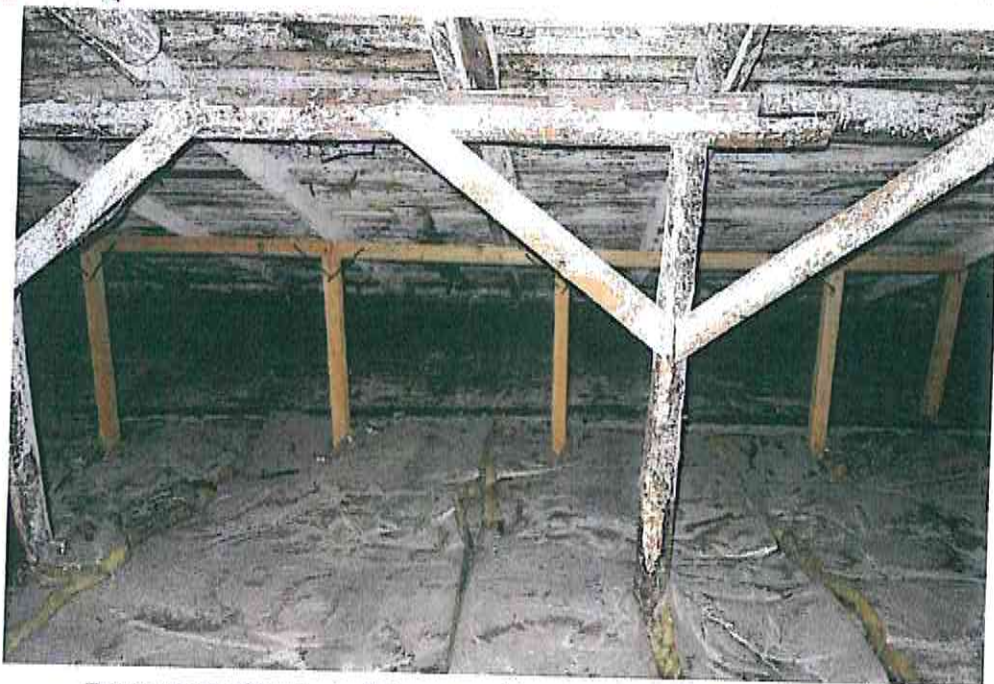
Fig. 7: Degradări la nivelul şarpantei(secţiuni neconforme-lemn rotund)
