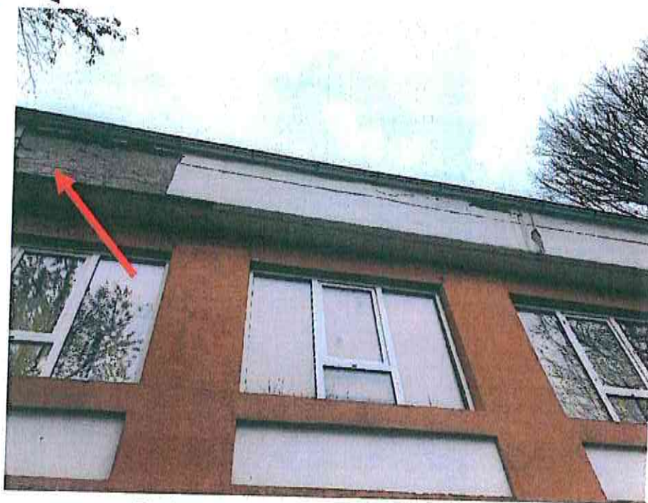
Fig.5: Tencuială desprinsă de pe stratul suport
