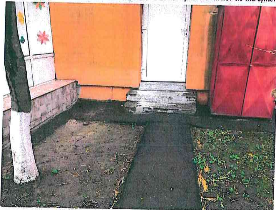
Fig.4: Trotuarele perimetrare nu sunt conforme, ceea ce a favorizat creșterea vegetației și stagnarea apei la nivelul fundațiilor
