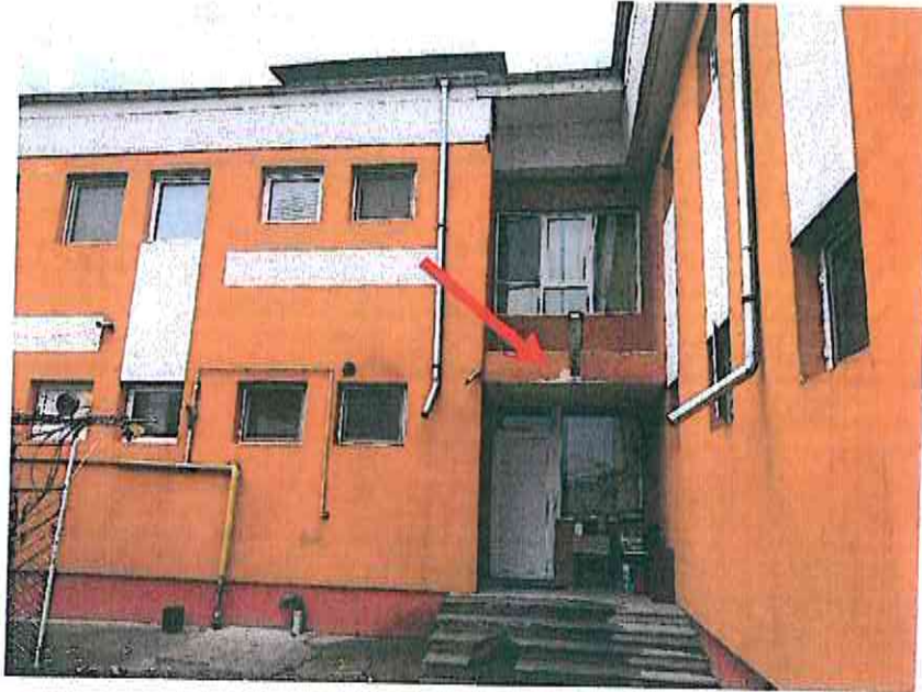
Fig.3: Fisuri aparente la nivelul finisajelor, datorită lipsei lucrărilor de întreținere
