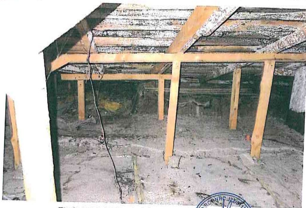
Fig.9: Degradări la nivelul șarpantei (infiltrații de apă)
