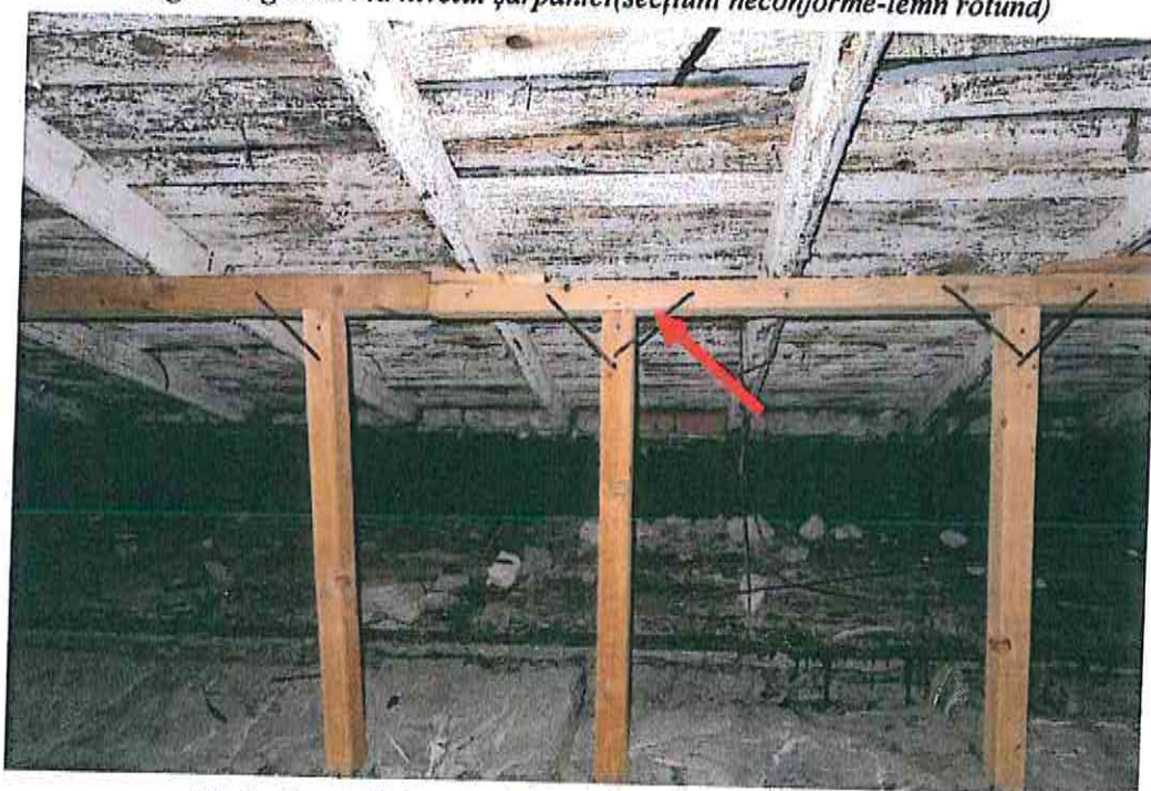
Fig.8: Degradări la nivelul şarpantei(îmbinare neconformă)
