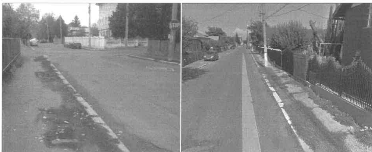
Figura 2.33. Trotuare în stare necorespunzătoare (Sursa: Google Earth, Arhiva Consultant, 2016).
